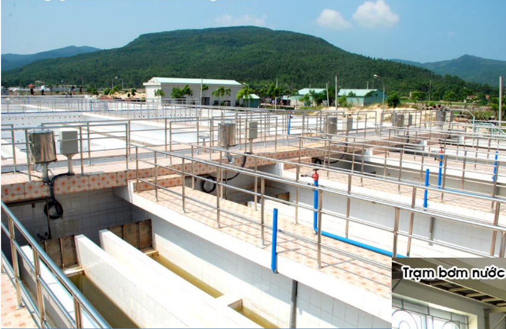
Bể lắng lọc NM nước Bình Minh - Nghi Sơn
